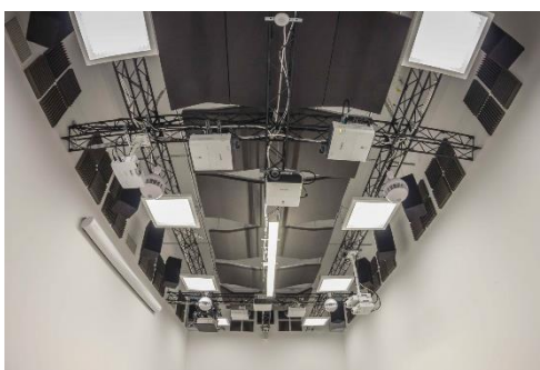
System podwieszonych pod sufitem rzutników i ustrojów akustycznych
